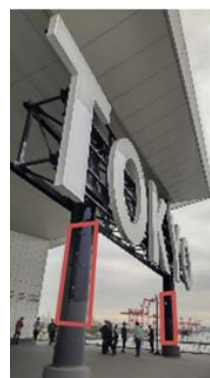
柱に設置した次世代型ソーラーセル
