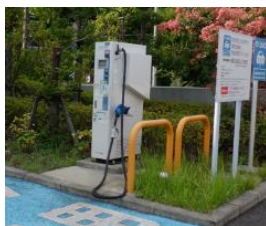
立川合同庁舎 急速充電設備
