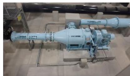
小水力発電設備
