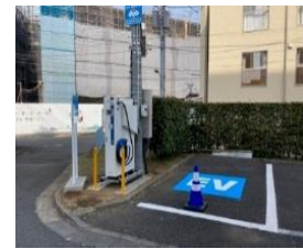
王子五丁目アパート 急速充電設備
