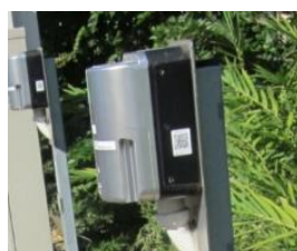
石神井公園 普通充電設備
