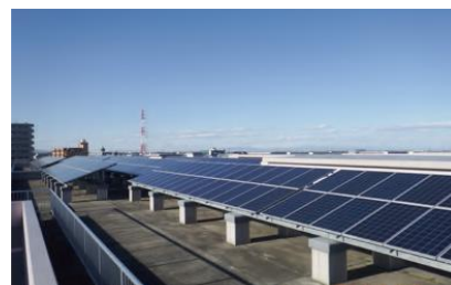
太陽光発電設備
